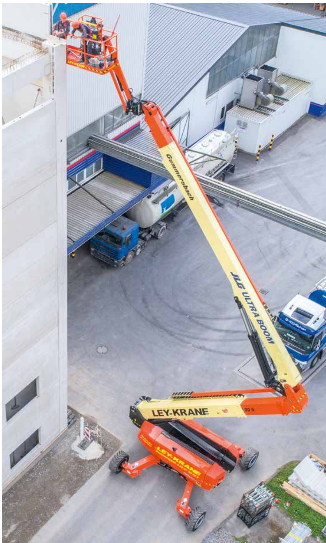
Beim Bau dieser Industrieanlage kann die JLG 1500AJP alle ihre Reichweiten- und Beweglichkeitsvorteile ausspielen.
