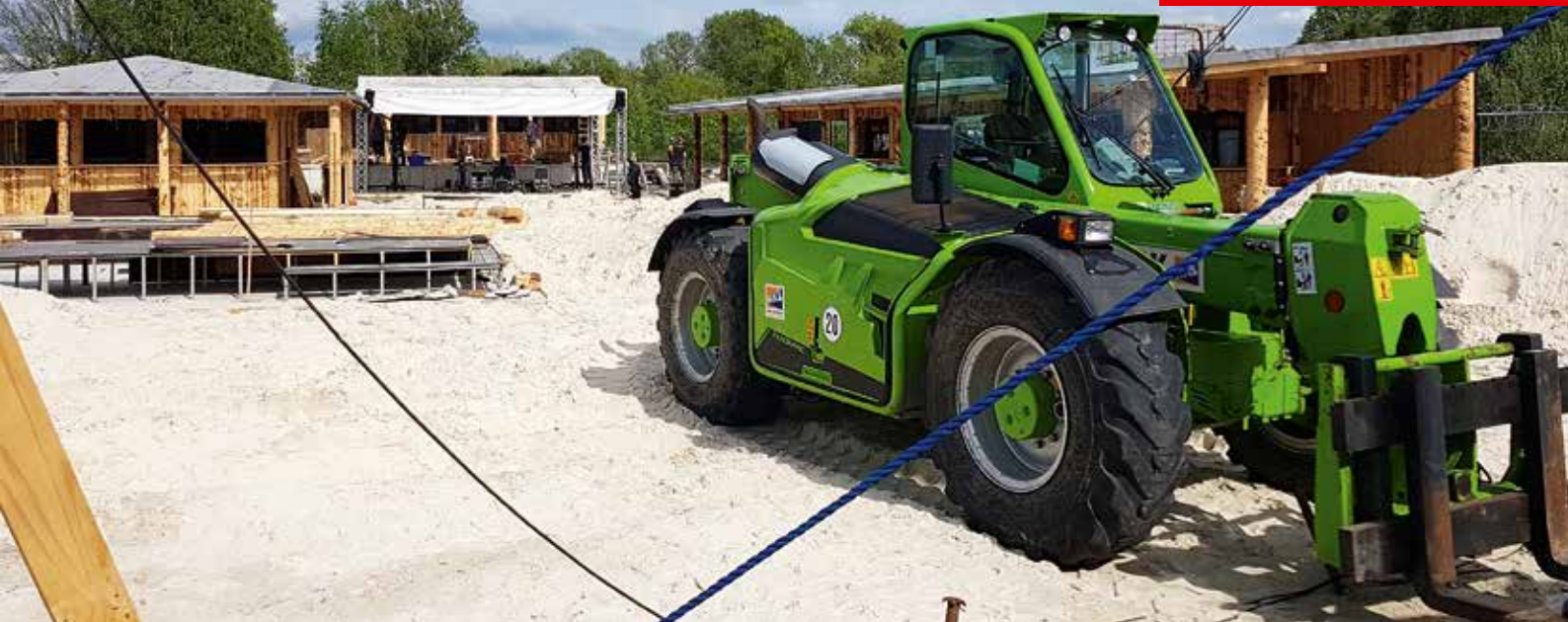
Ein Merlo Teleskopklader aus dem HKL Arbeitsbühnen und Teleskopcenter NRW wurde für den Materialtransport eingesetzt.
