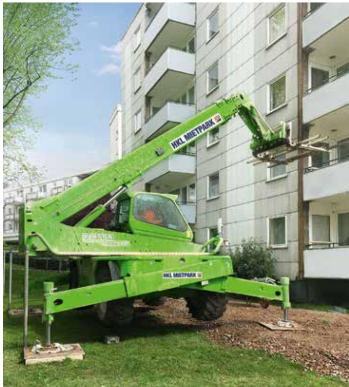
Der Merlo Roto 45.21 Teleskopstapler aus dem HKL Mietpark stützte die Bodenplatten der Balkone und transportierte sie direkt am Haus entlang ab.
