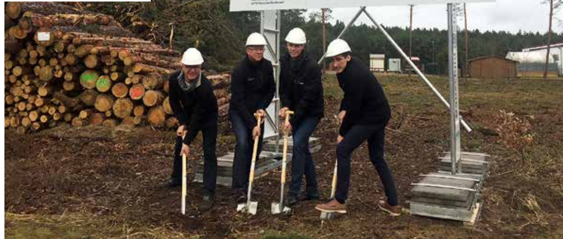
v.l.n.r.: Georg Scheidtman (Projektleiter, Briese Baumanagement), Rolf Kulawik (Geschäftsführer, Ruthmann), Thomas Benne- mann (Leiter Service International, Ruthmann) und Christian Kauschke (Leiter Ruthmann Servicestation Borkheide) setzen den ersten Spatenstich.
