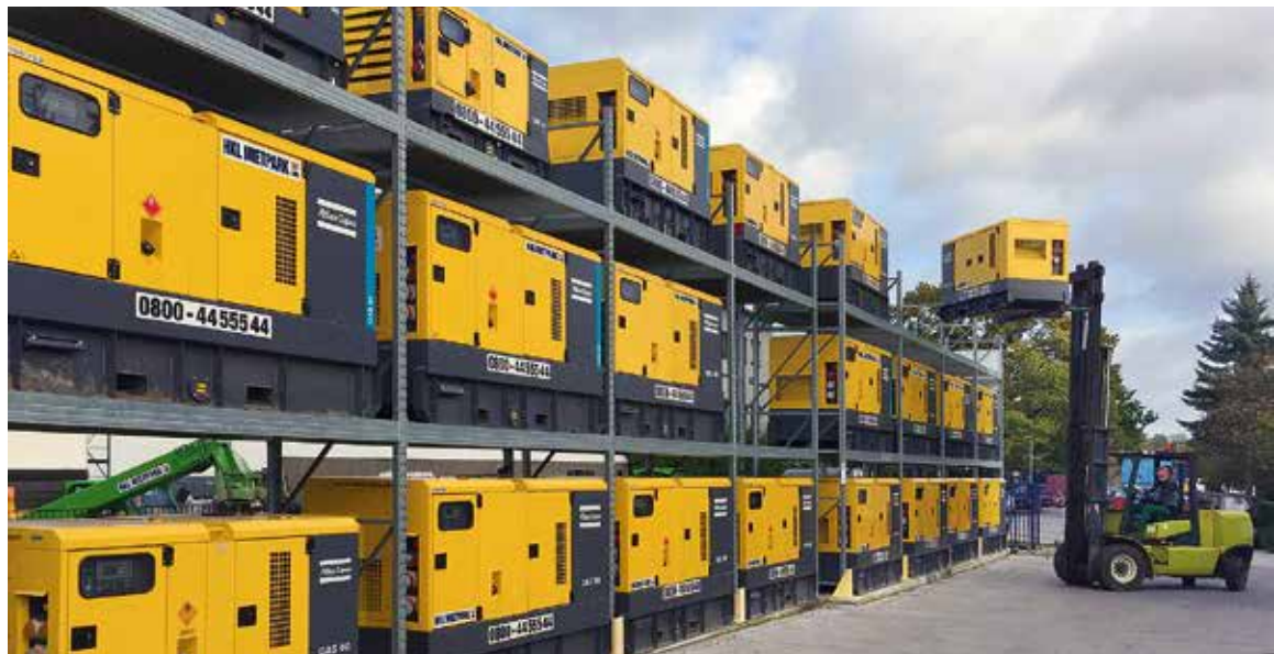
In den sechs neuen Stromcentern bündelt HKL seine Kompetenz rund um Strom und Lichtenergie.
