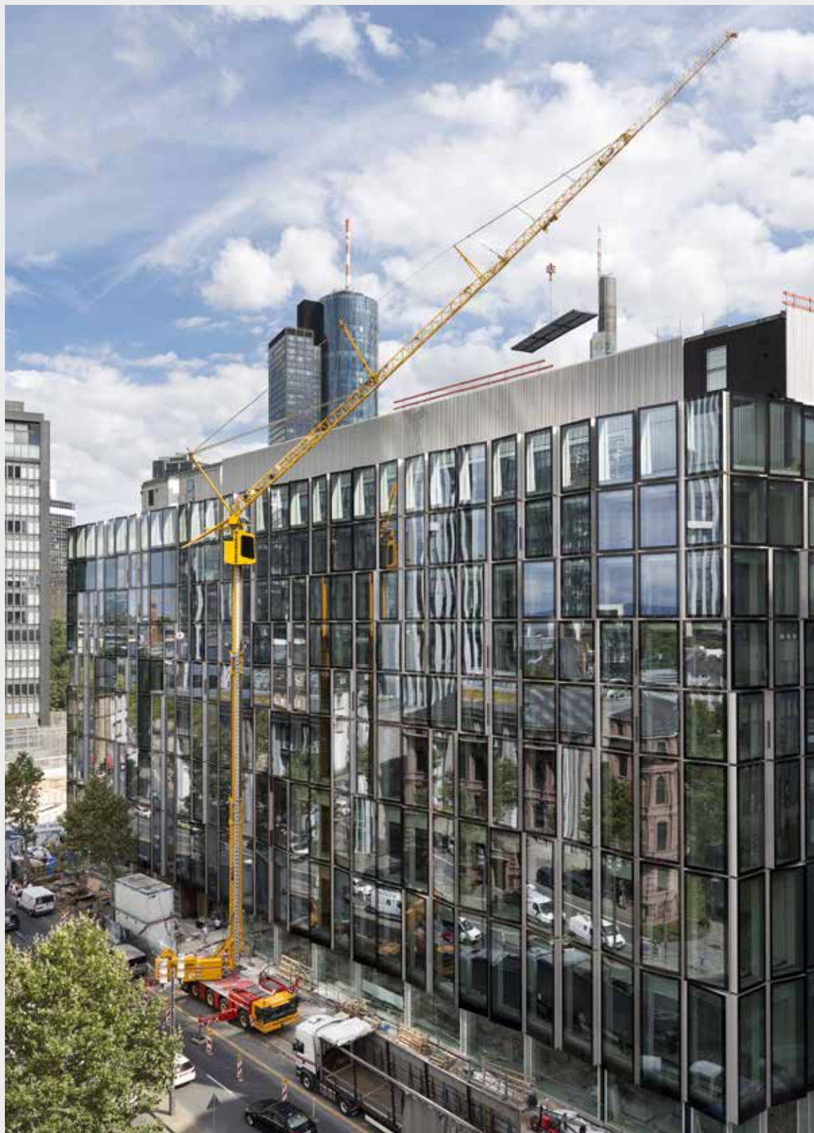
Der Liebherr-Mobilbaukran MK 140 von Wiesbauer war bei diesen Dacharbeiten im Frankfurter Bankenviertel im Katzmodus im Einsatz.
