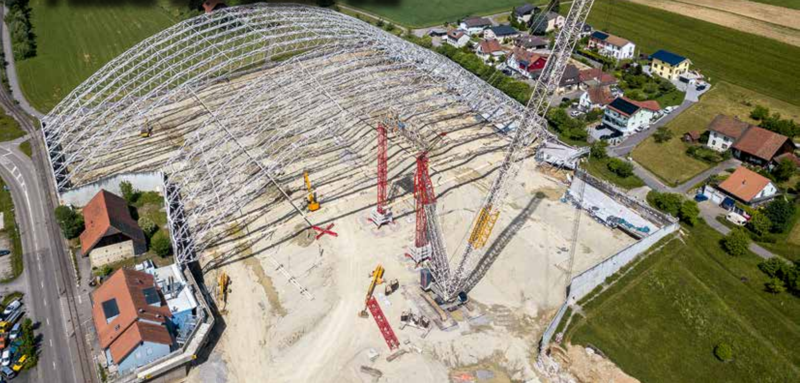
Arbeitspause am Wochenende, die „white Edition“ steht vor den noch rückzubauenden Dachbögen.
