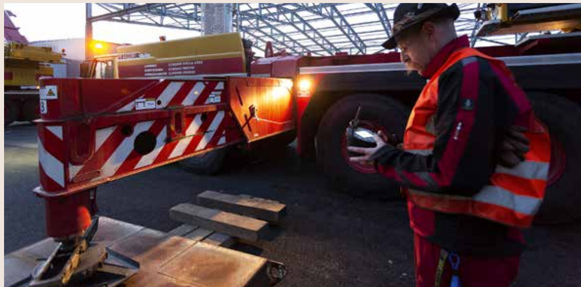
Rüstzeit: Kurz nach Morgengrauen werden die sechs Krane für den gemeinsamen Hub vorbereitet. Hier werden die Stützen des LTM 1300-6.2 ausgefahren.
