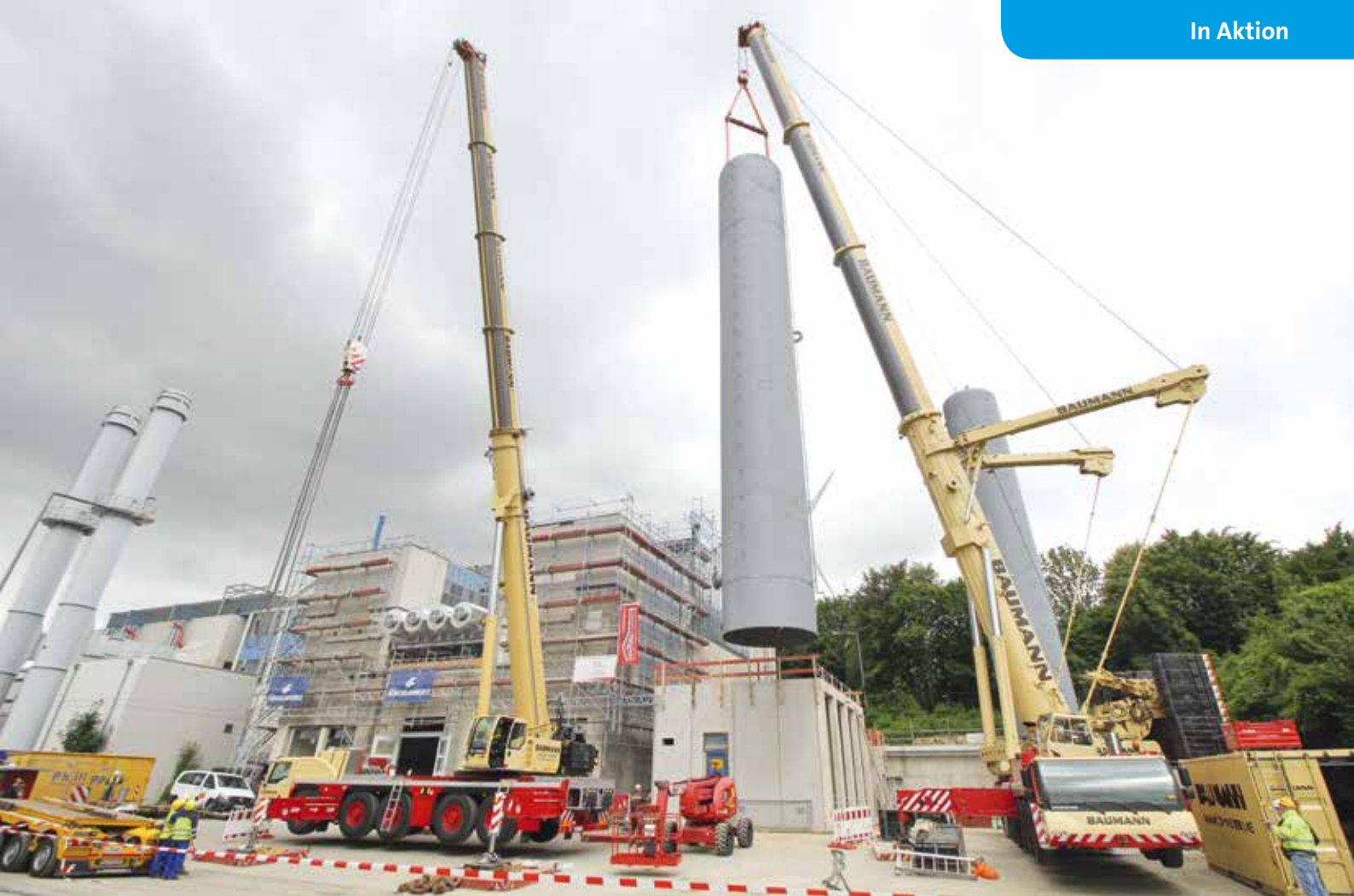
Die 47,3 m Hauptausleger reichen so gerade eben aus, um den Pufferspeicher über die neuerrichtete Transformatorhalle zu heben.
