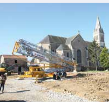
Agesibat setzt den Potain Hup 30-40 bei der Errichtung von elf Häusern ein.
