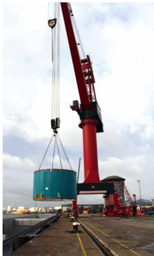
Neben dem Transport war Mammoet auch für den Umschlag der Tunnelbohrmaschine verantwortlich.
