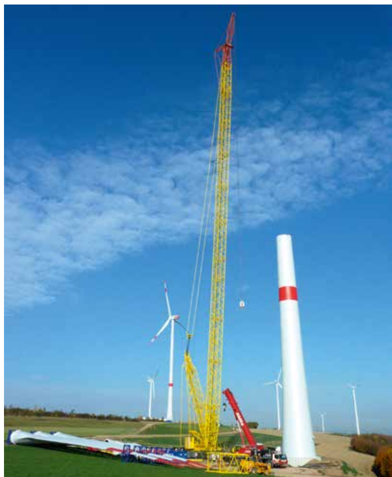
Windkraftanlagen werden zunehmend größer – das fordert auch die Kran- und Schwertransportbranche. STM-Bild
