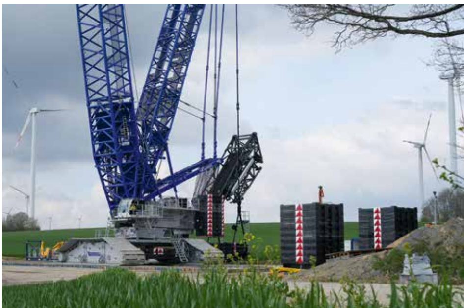
Grundgerät LR 11000 – deutlich erkennbar der V-Frame, der eine flexible Positionierung des Derrickballastes erlaubt. Rechts neben dem Kran sind 450 t Ballast aufgebaut, die nur zum Auf-/Abwippen des Auslegers benötigt werden.
