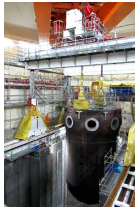
Reaktordruckbehälter wird horizontal in die Halteposition verfahren.
