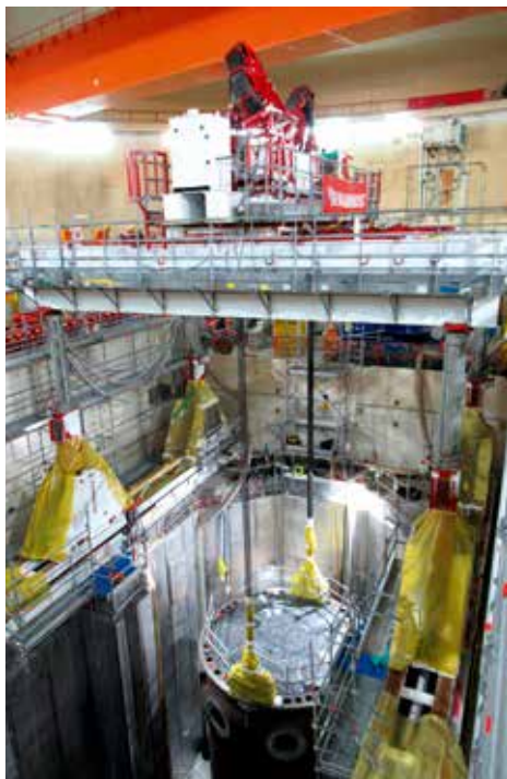
Vierpunkt-Hubgerüst SBL 1100 installiert auf dem Beckenflur.
