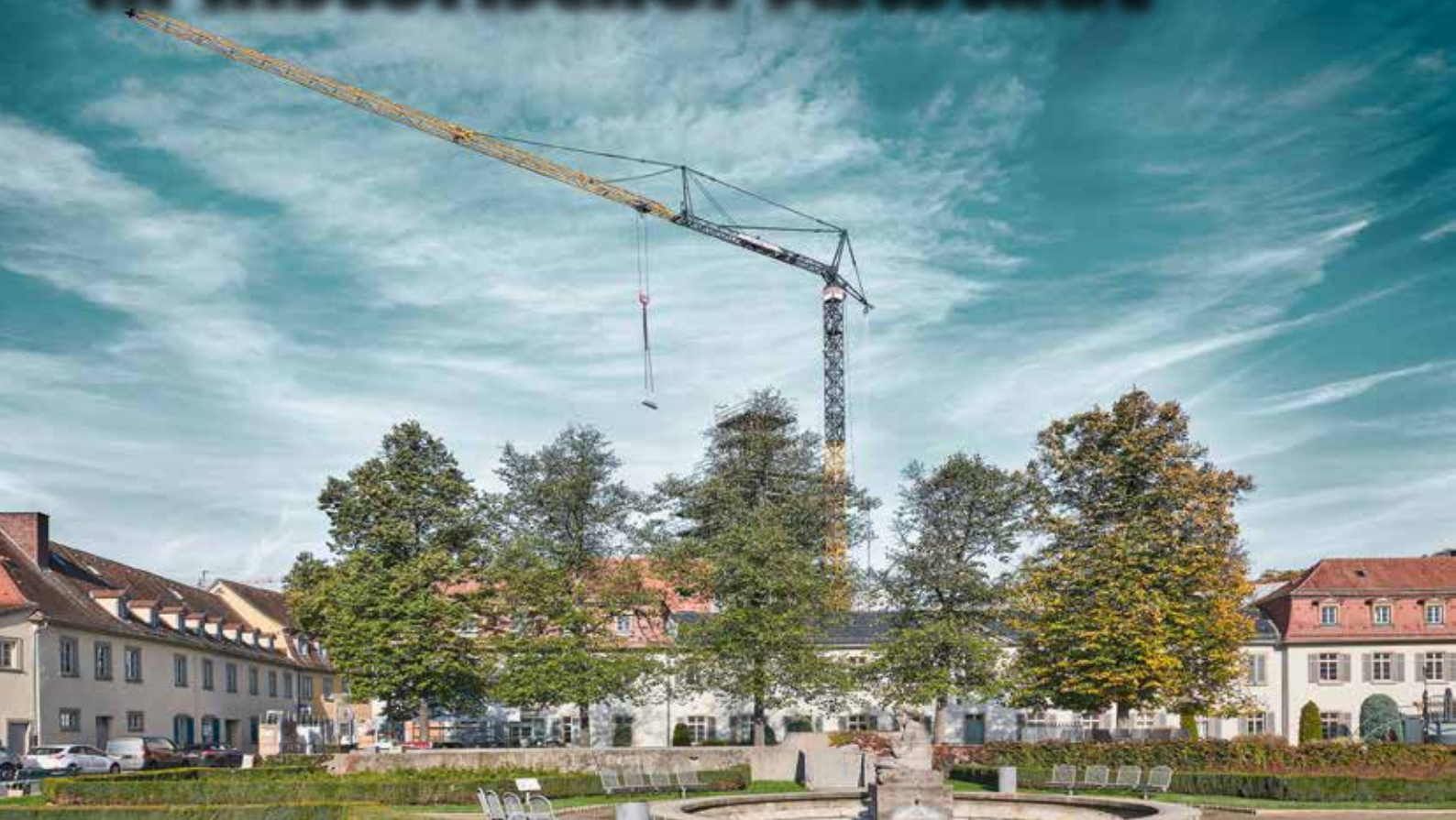
Der Untendreherkran 81 K.1 von Liebherr bei der Sanierung des ehemaligen Residenzschlosses Geyerswörth.
