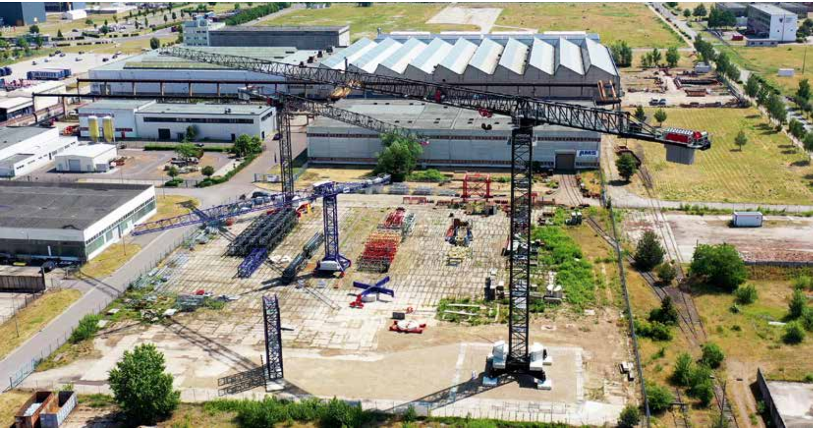
Übersicht AMS-Außengelände mit drei TDKs, im Hintergrund die AMS-Werkshallen in Arneburg.
