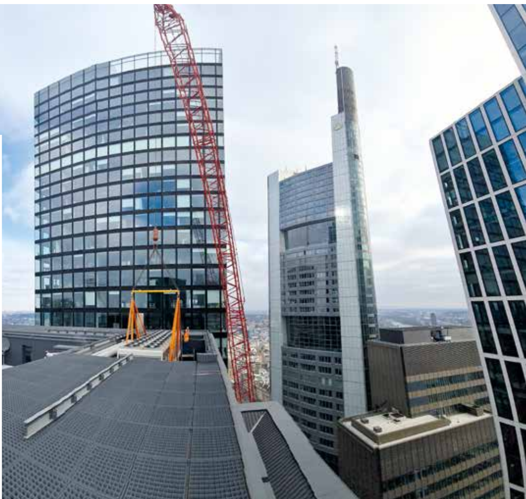
Auf dem Dach des Japan Towers in Frankfurt: Klimaanlage-tausch über eine massive Störkante hinweg.
