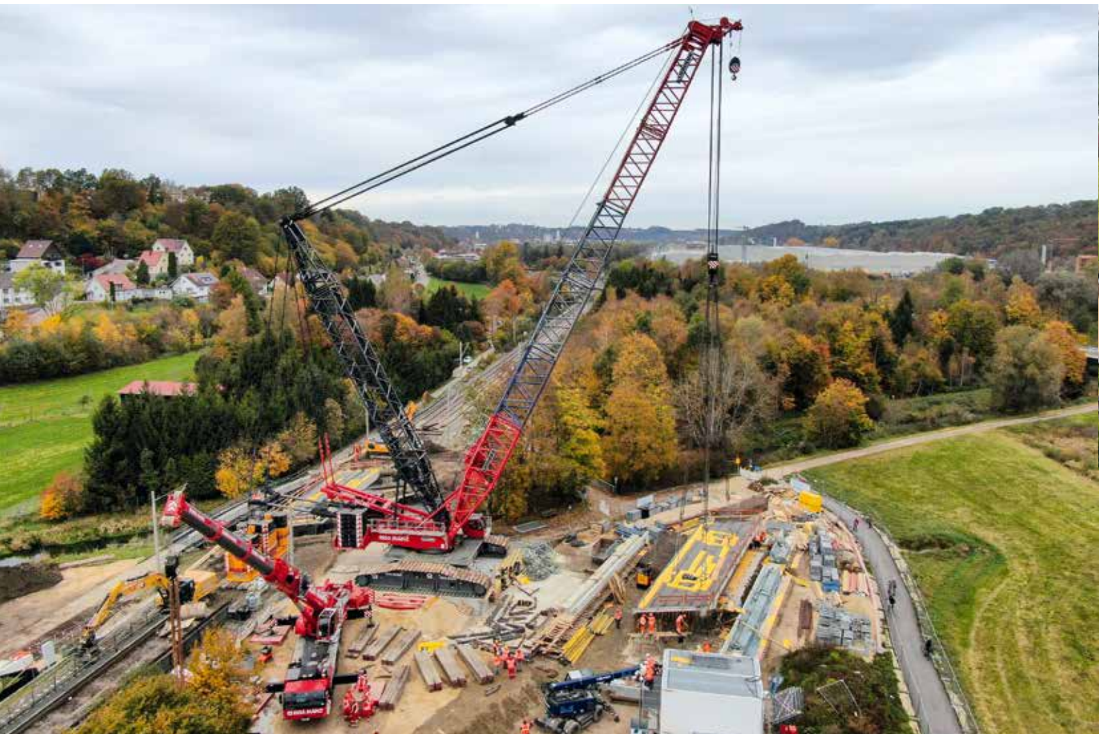
RIGA MAINZ montiert mit einem LR 1750/2 zwei Stahlbetonbrückenteile über die Riß bei Biberach.
