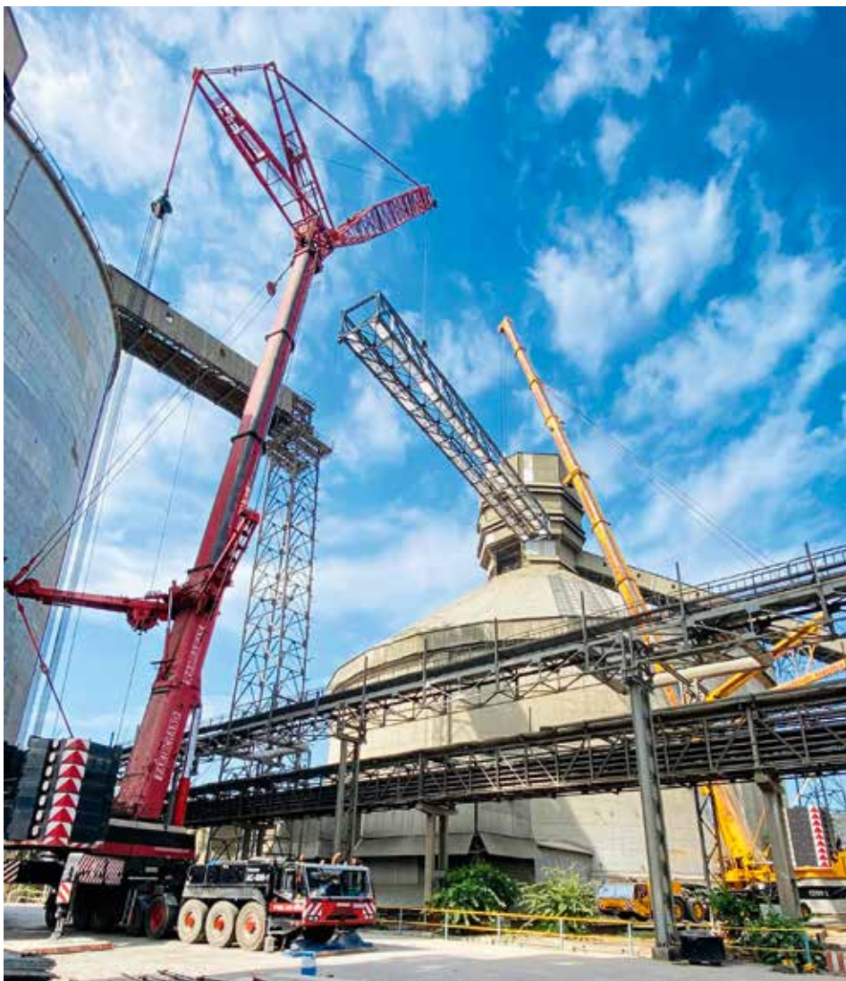
Per Tandemhub heben ein AC 1000-9 und ein AC 500-1 das neue Förderband in einem indischen Zementwerk.
