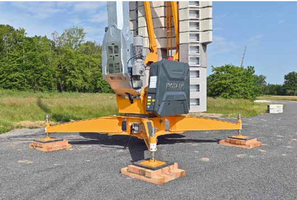
Das Fußkreuz und der Schaltschrank mit den Steuereinheiten.
