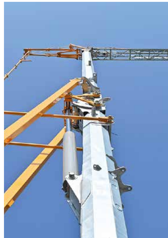
Gut erkennbar: die Hydraulik-Einheit zum Klappen am Turmmast.
