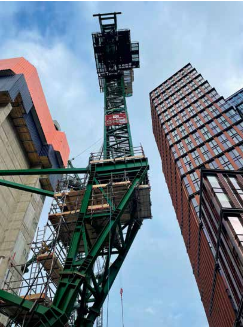
Der MR 418 wurde auf einer erhöhten Gitterstahl-Plattform installiert.
