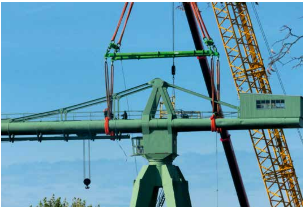
Die Hübe zur Kontrolle der korrekten Position der Hubschlingen waren nicht zu erkennen.
