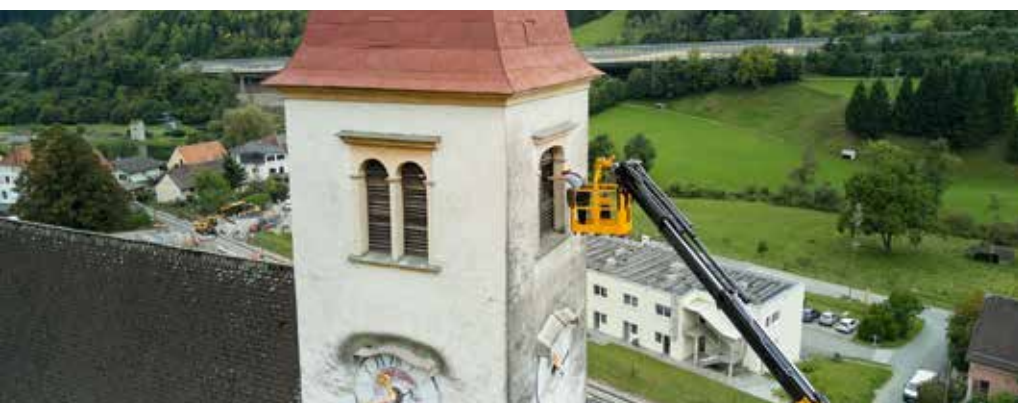
Die Mobilfunksende-Anlage ist im Kirchturm „versteckt“.
