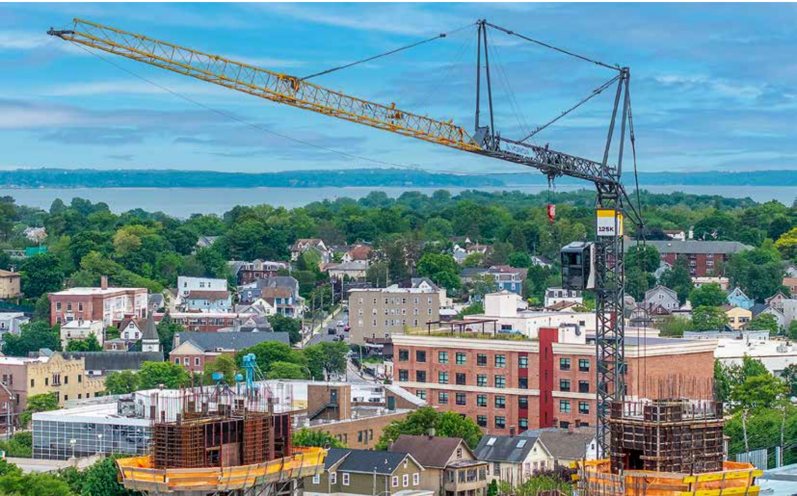
Der 125 K arbeitet an einer zwölfstöckigen, gemischt genutzten Siedlung in der Westchester Avenue, New York.
