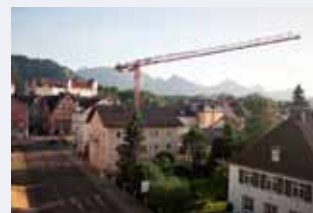
Auf einer Baustelle in Füssen kommt der WOLFF 6015.8clear mit 33 m Hakenhöhe zum Einsatz.
