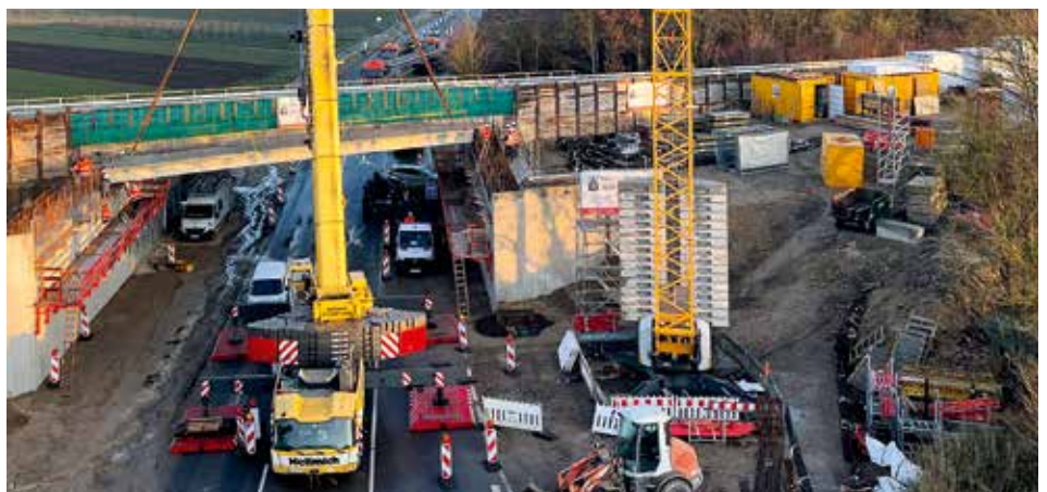
Ein 300 t-6-Achs mit 72 t GG in Zukunft 12 Wochen Vorlaufzeit für die Fahrtgenehmigung und Begleitkosten, die das 5-fache des Kraneinsatzes kosten? Hier bei der Sanierung einer Brücke – kommen wir da in Zukunft überhaupt noch „Just-in-time“ hin?
