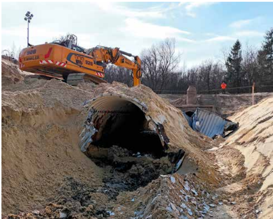
Die morsche Wasserleitung hatte sich zur Hälfte mit Ausspülungen gefüllt.
