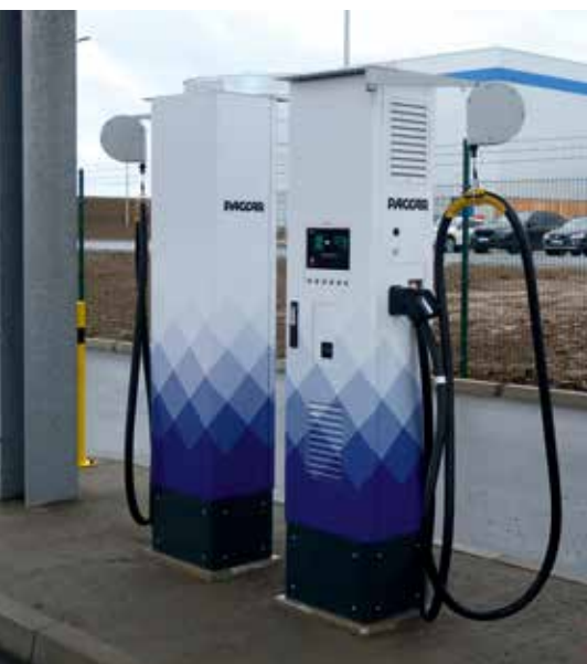
Die überschüssige Energie aus der Solaranlage wird gespeichert und beispielsweise für das Laden von E-Lkw genutzt. STM-Bild
