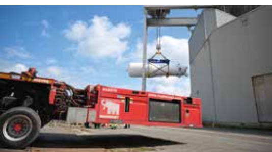
Dampferzeuger am Haken des Portalbrückenkrans. Das Transportfahrzeug steht schon zur Aufnahme bereit.
