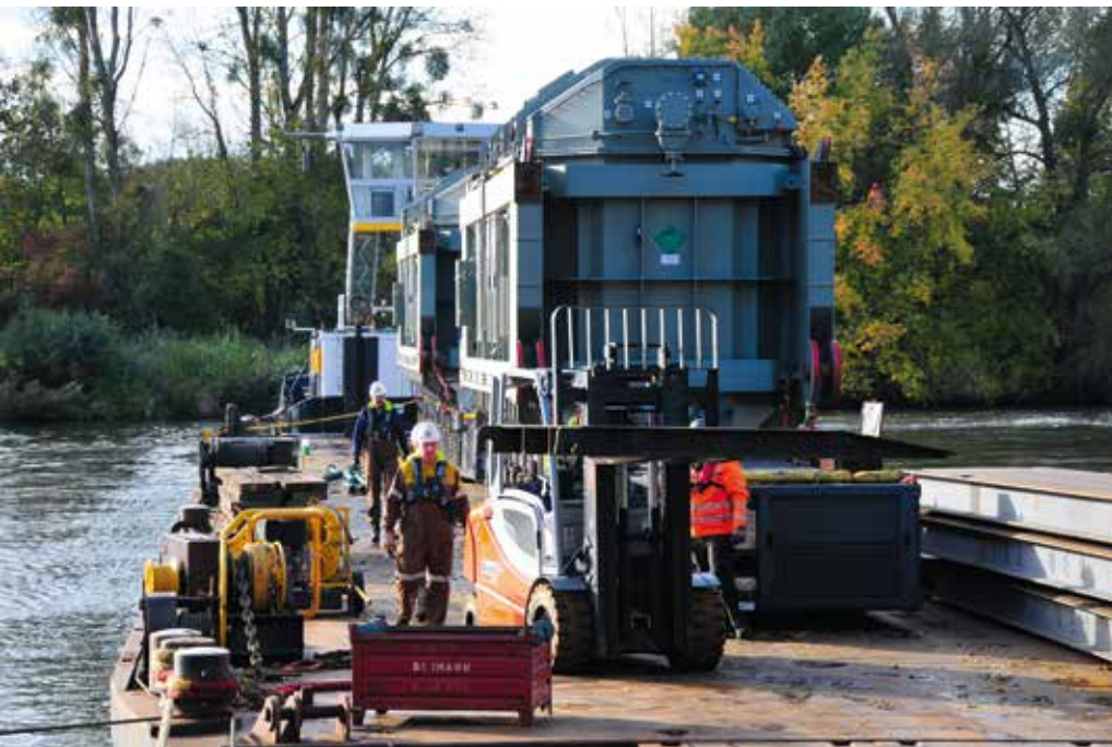
Auf einem Ponton kommen die beiden Transformatoren, jeweils schon auf einer 14-Achs SPMT-Einheit platziert, in Maintal an.
