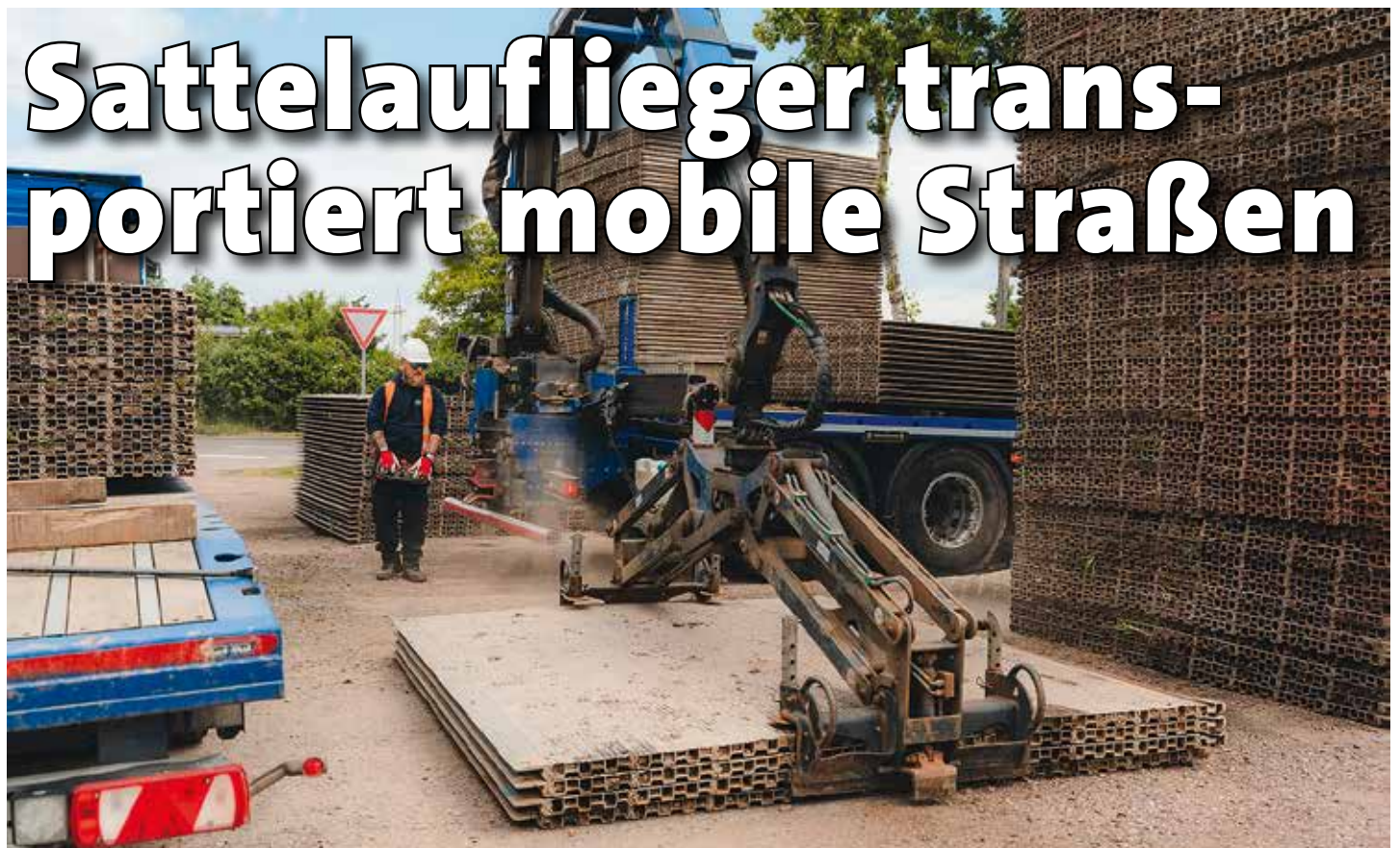
Mit dem am Heck montierten Ladekran werden gleich mehrere Elemente der mobilen Straßen aufgeladen.
