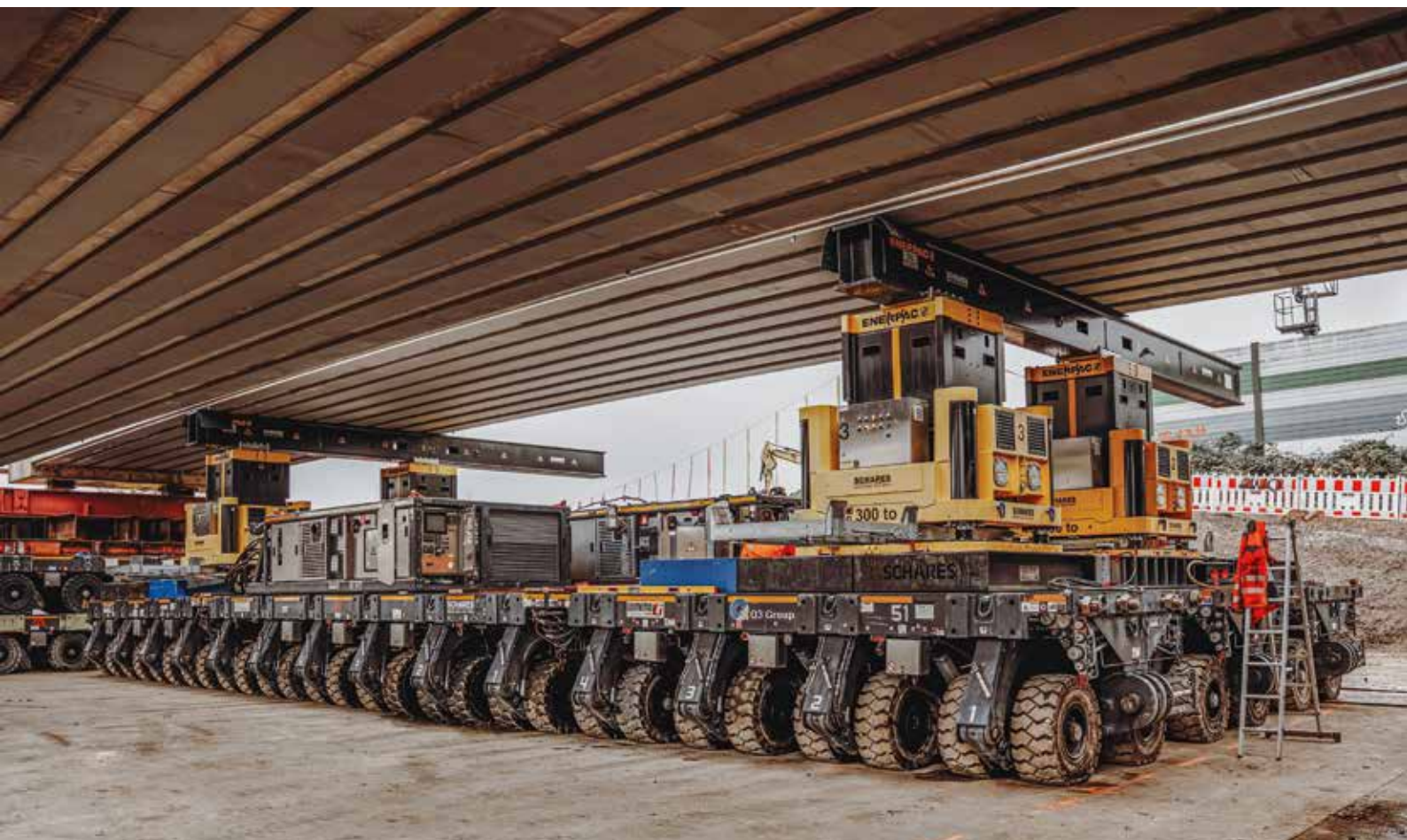
Auf den Cometto MSPE-Fahrzeugen hatte Schares noch Jack-UP-Systeme von Enerpac platziert, auf denen die Brückenelemente platziert waren und mit deren Hilfe die Elemente später in die Endposition gehoben wurden.
