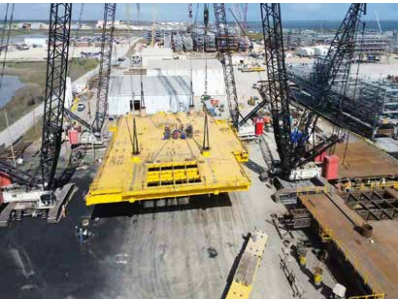
Insgesamt vier Raupenkrane heben eine Plattform an, die auf eine Tragkonstruktion platziert werden soll.
