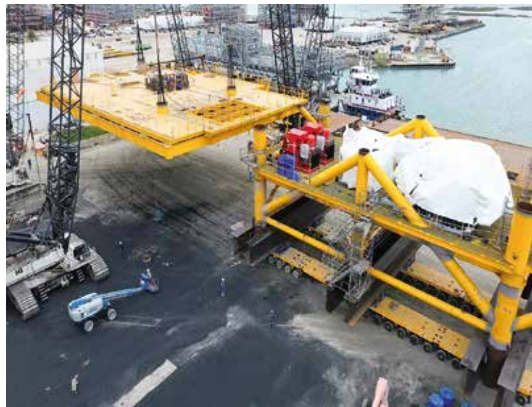
Nach der Anlieferung der neuen Cometto SPMT-Achslinien gingen diese direkt in ihren Ersteinsatz. Mit den Selbstfahrern wird die Tragkonstruktion genau unter der Plattform platziert.
