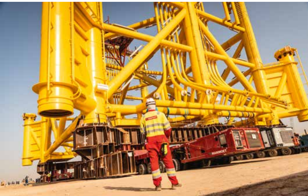
Angetrieben wurden die 216 Achslinien von insgesamt vier Power Pack Units (PPUs).
