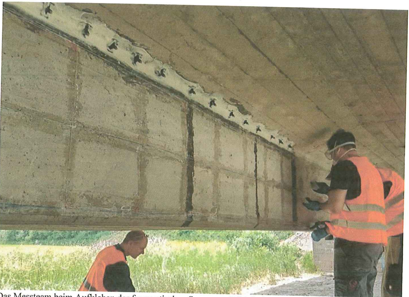
Das Messteam beim Aufkleben der faseroptischen Sensoren. (Bild: Lehrstuhl für Massivbau / TUM)
