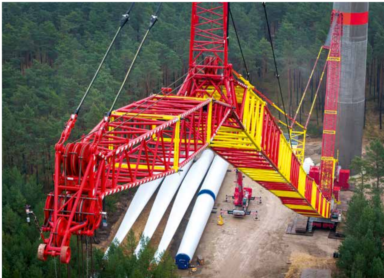
Neeb's LR 1800-1.0 bei Aufrichten des Mastes. Der Kran war mit insgesamt 400 Tonnen Schwebelast aufgerüstet.
