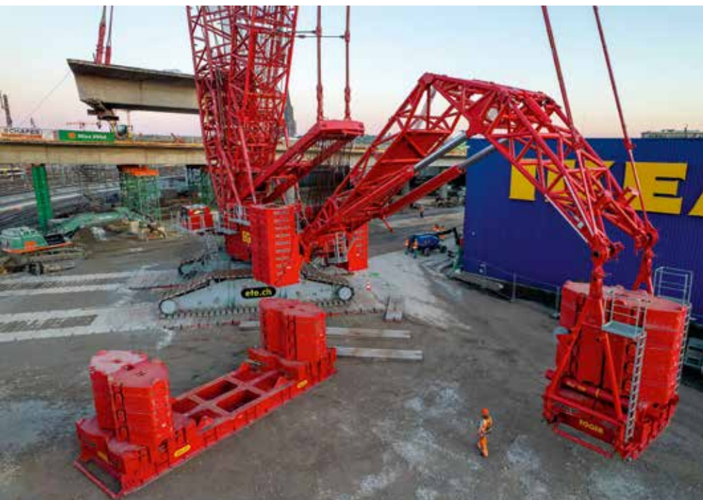
„Der hydraulisch verstellbare Klapprahmen V-Frame sowie der teilbare Derrickballast VarioTray waren bei dem Einsatz wertvolle Features“, ...
