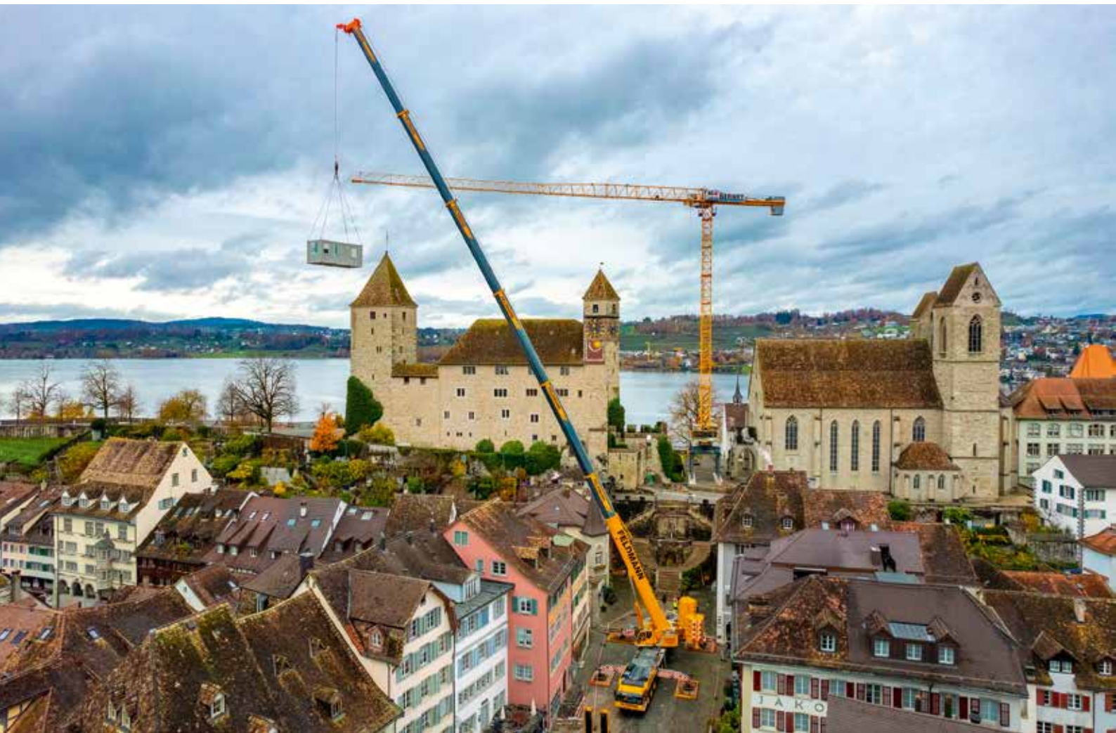
800 Jahre alte Kulisse: Neben dem Aufbau des Turmdrehkrans erledigte der LTM 1450-8.1 auch den Hub der Baustellenausrüstung.
